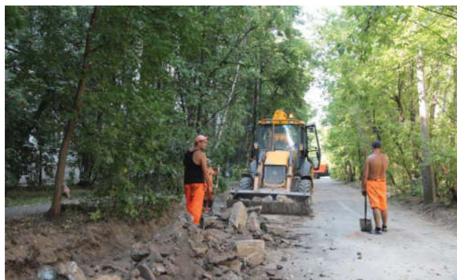
Ремонт на проезде от Новомытищинского проспекта к дому 39, корп. 1 и к дому 45, корп. 4, 5
