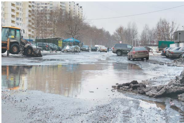
Дорога на ул. Воронина долгое время находится в плачевном состоянии
